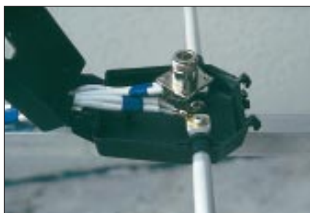
Bild 3: In dieser Antennendose ist deutlich die Montage der N-Buchse zu erkennen.
